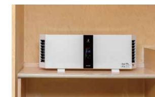
ロビー空気清浄機設置
